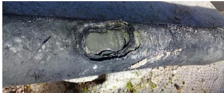
Figura IX.5 Falla ocasionada por propela de una embarcación.
